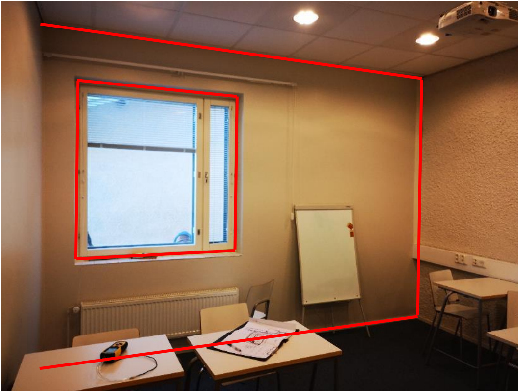
Kuva 17. Vuonna 2007 rakennetun koulurakennuksen tyypillisimmät epätiiveyskohdat.
