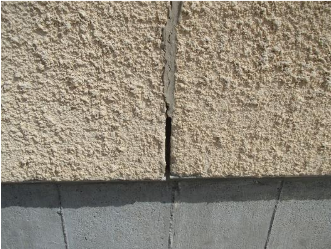
Kuva 12. Julkisivujen elastiset saumamassat ovat ikääntyneet ja irronneet reunoistaan.
