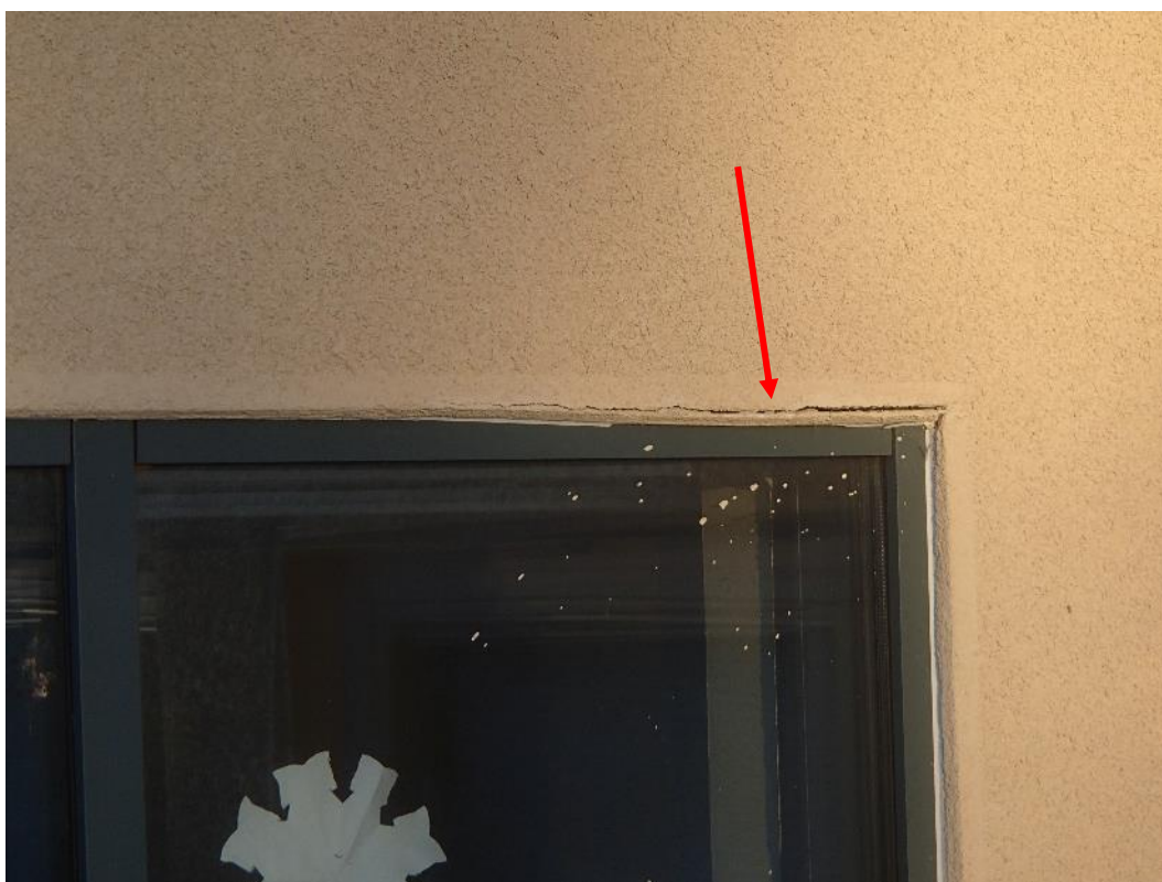
Kuva 9. Paikoin julkisivuilla havaittiin halkeilua.
