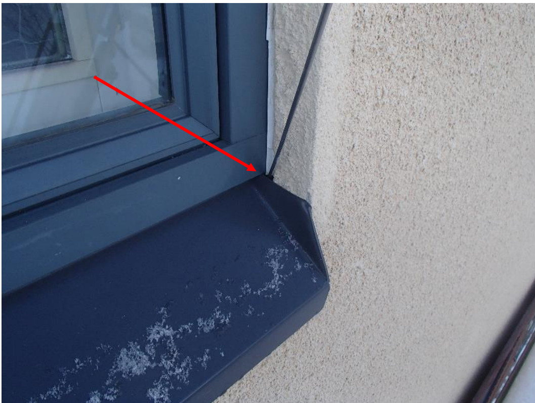
Kuva 13. Paikoin vesipeltien kulmissa on rakoja eristetilaan.
