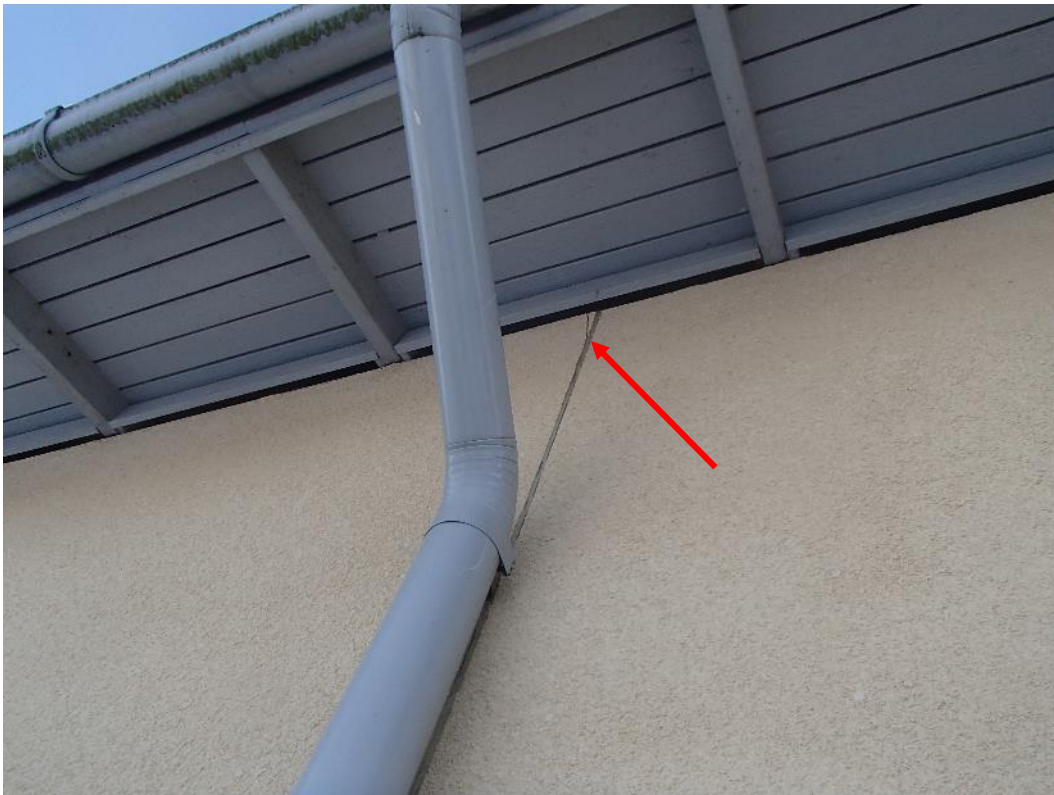
Kuva 14. Paikoin julkisivupinnoilla on halkeilua.
